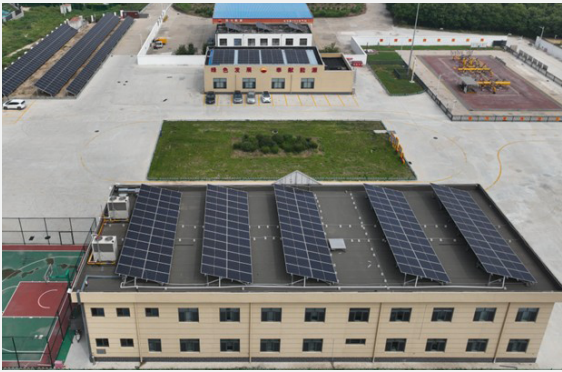
聊城公司九州门站分布式光伏项目
