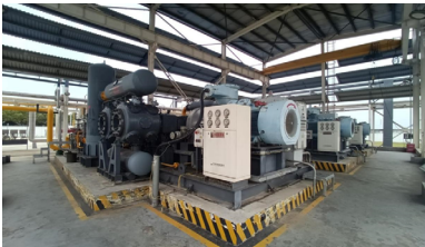
黄冈 LNG 工厂 BOG 回收改造项目
